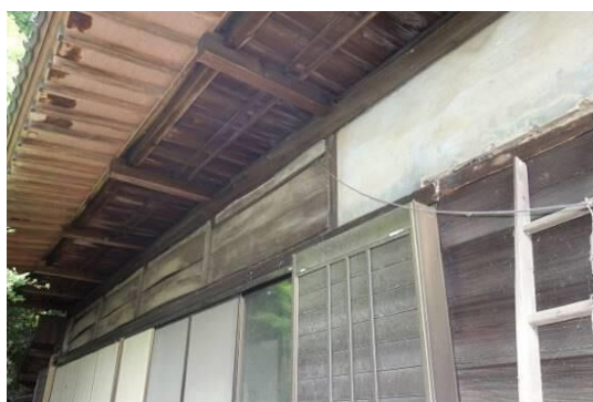
垂木裏板の染み
