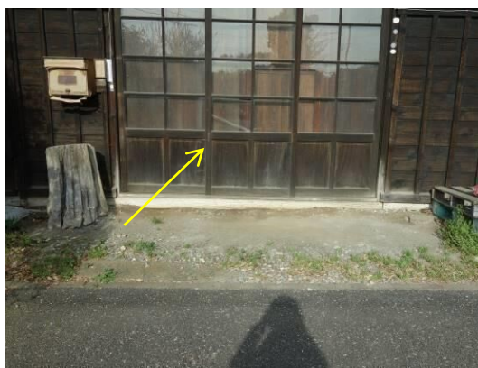
正面建具のガラスの割れ
