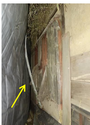
主屋背面の外壁際からモウソウチクが伸長
