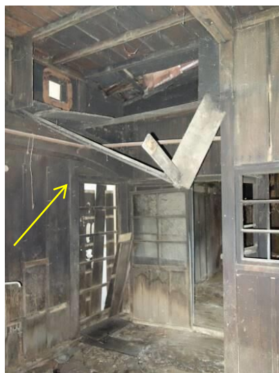
ドマ（奥）の上部棚の崩壊
