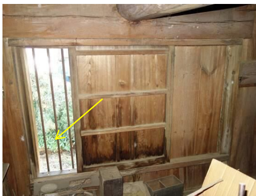
2階の面格子の錆
