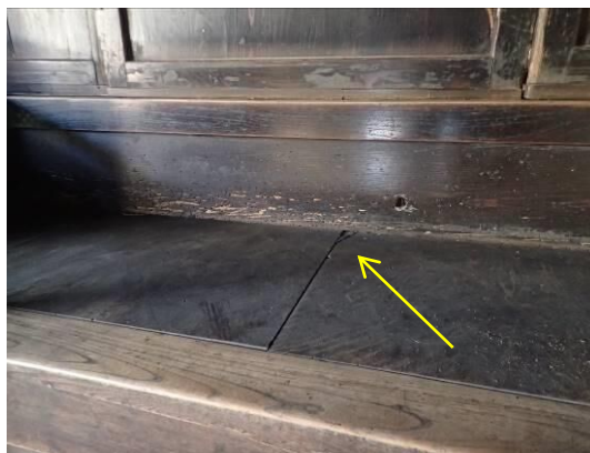
ザシキ上がり框の羽目板の虫食い
