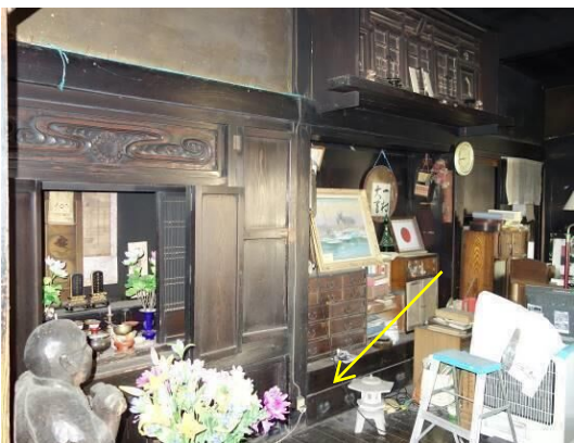
ザシキ押板下部の棚の破損状況
