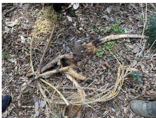
床下に発生していたモウソウチク
