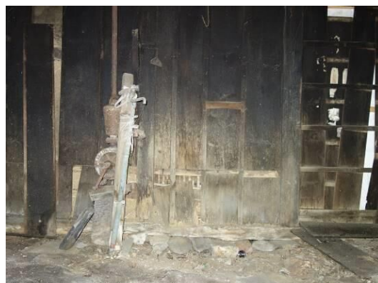
板壁の汚損（ドマ（奥））
