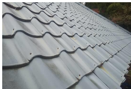
瓦型鉄板葺に発生した錆
