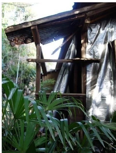
南西隅のベンジヨの破損状況
