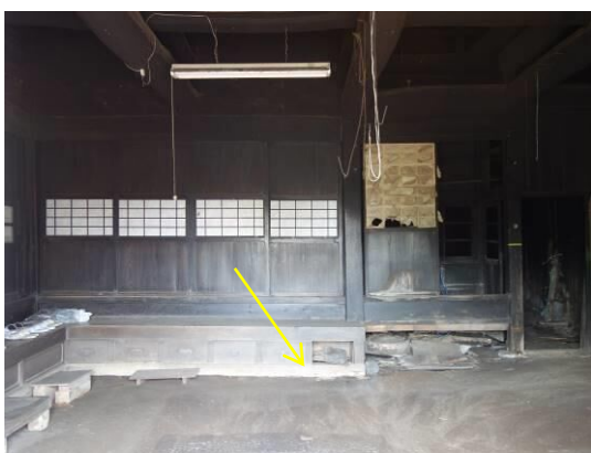
ドマ（手前）の上がり框下部の棚板の外れ
