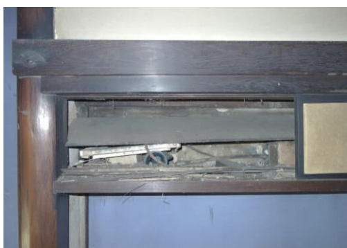
オク天袋内の天井板の外れ
