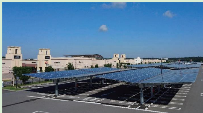
写真 酒々井プレミアム・アウトレットのカーポート型太陽光発電設備
