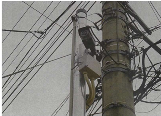
防犯カメラの設置
